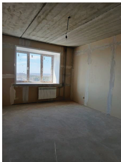
Фото 10. Состояние внутренней отделки кв.119
