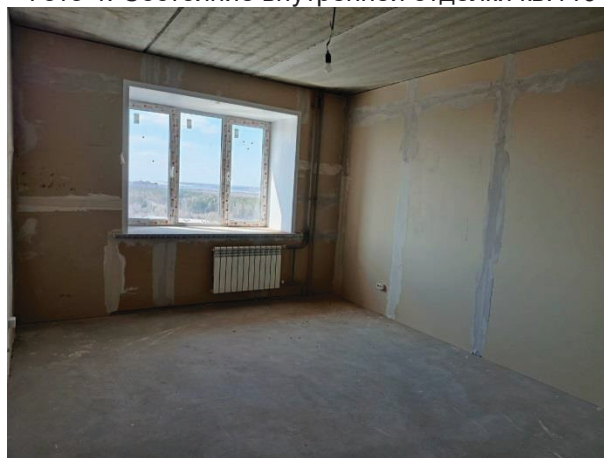
Фото 6. Состояние внутренней отделки кв.119
