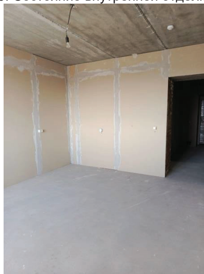
Фото 12. Состояние внутренней отделки кв.119
