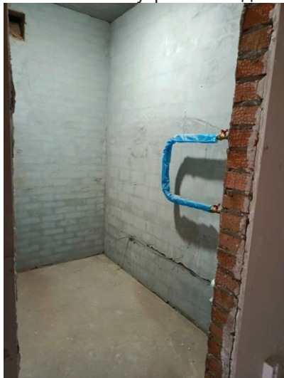
Фото 19. Состояние внутренней отделки кв.119
