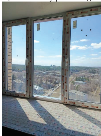
Фото 14. Состояние внутренней отделки кв.119
