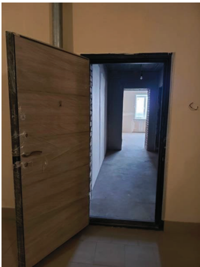
Фото 3. Состояние внутренней отделки кв.119
