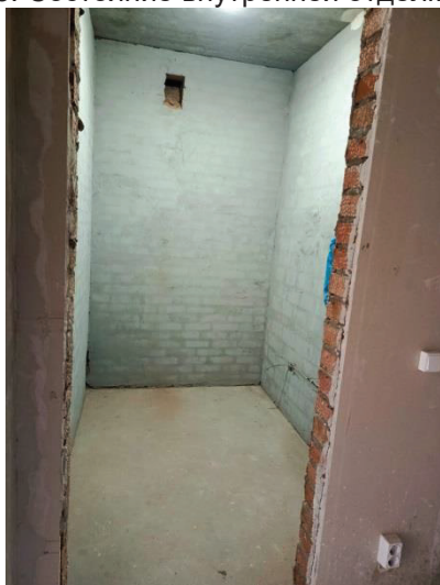
Фото 17. Состояние внутренней отделки кв.119
