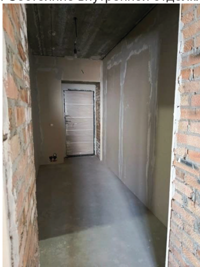
Фото 11. Состояние внутренней отделки кв.119
