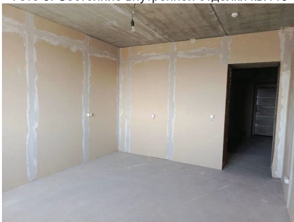
Фото 5. Состояние внутренней отделки кв.119
