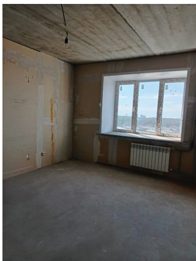
Фото 9. Состояние внутренней отделки кв.119
