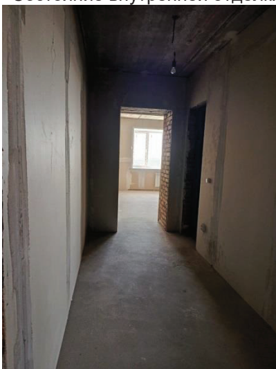
Фото 7. Состояние внутренней отделки кв.119
