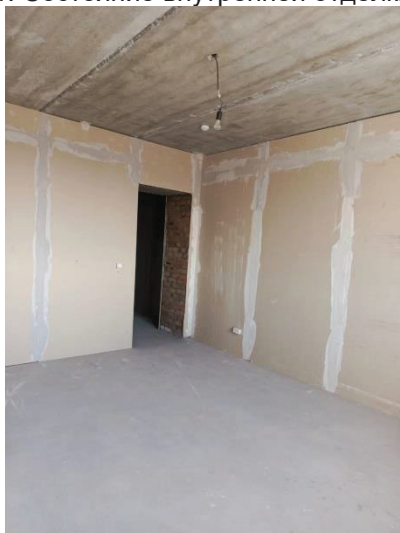
Фото 13. Состояние внутренней отделки кв.119
