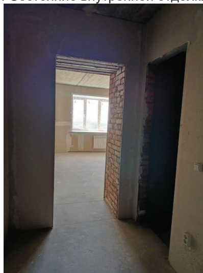
Фото 8. Состояние внутренней отделки кв.119
