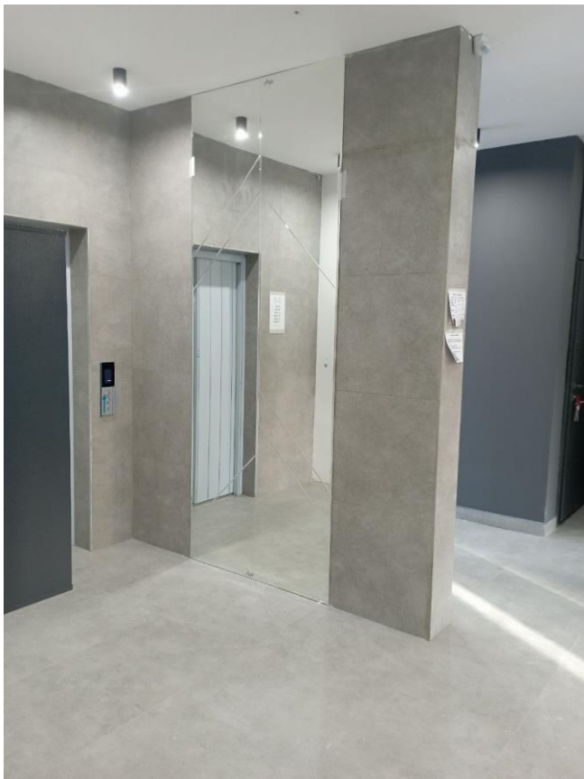
Фото №9 Техническое состояние подъезда
