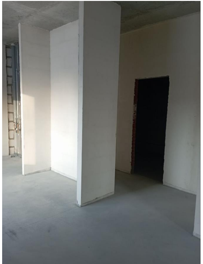
Фото №2 Техническое состояние внутренних помещений квартиры
