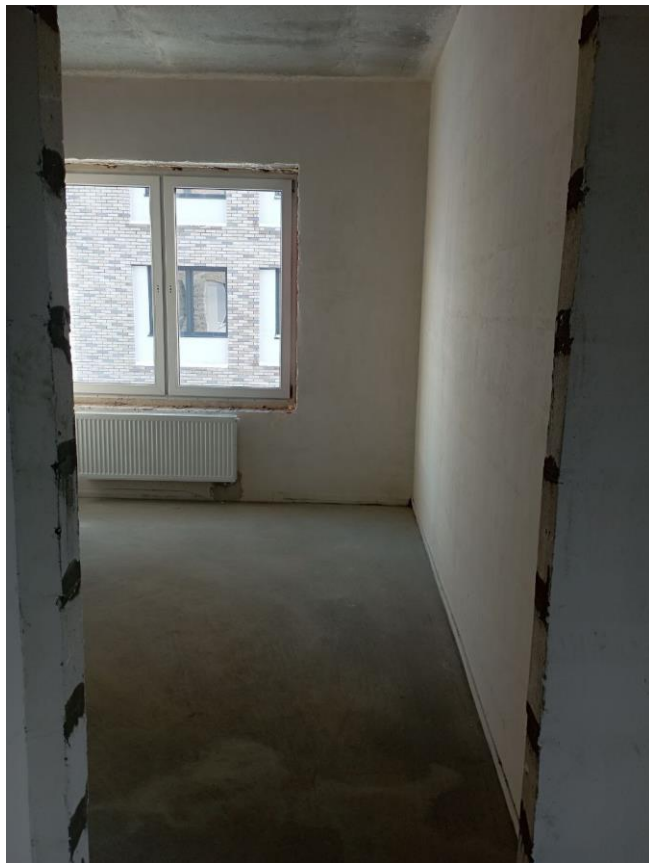
Фото №6 Техническое состояние внутренних помещений квартиры
