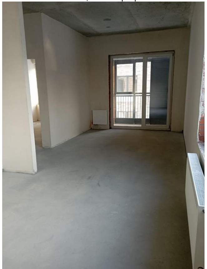
Фото №4 Техническое состояние внутренних помещений квартиры
