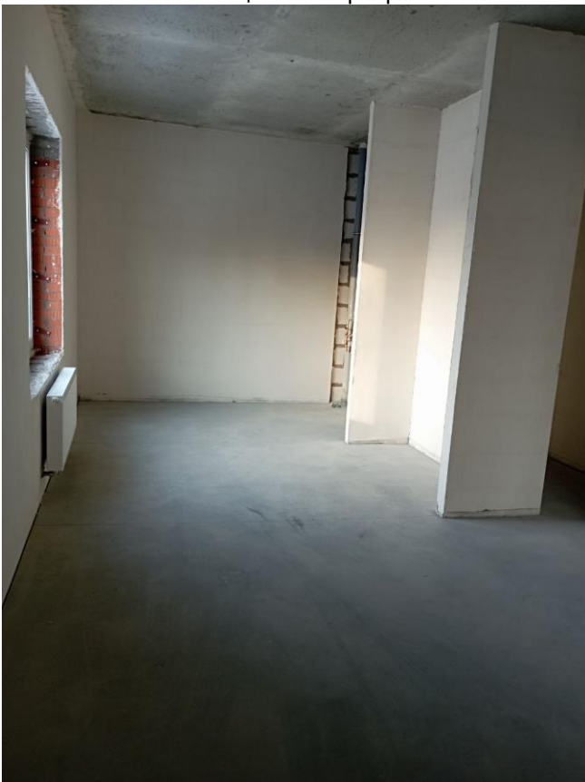
Фото №3 Техническое состояние внутренних помещений квартиры
