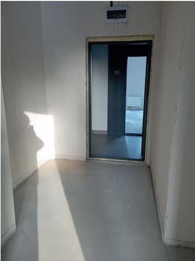
Фото №1 Техническое состояние внутренних помещений квартиры
