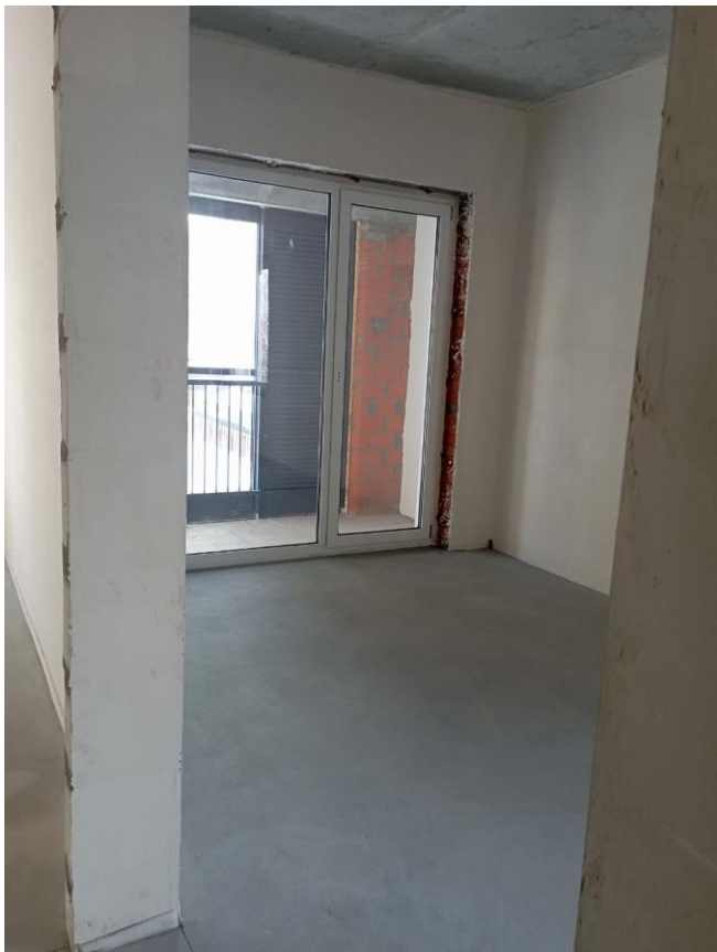
Фото №5 Техническое состояние внутренних помещений квартиры
