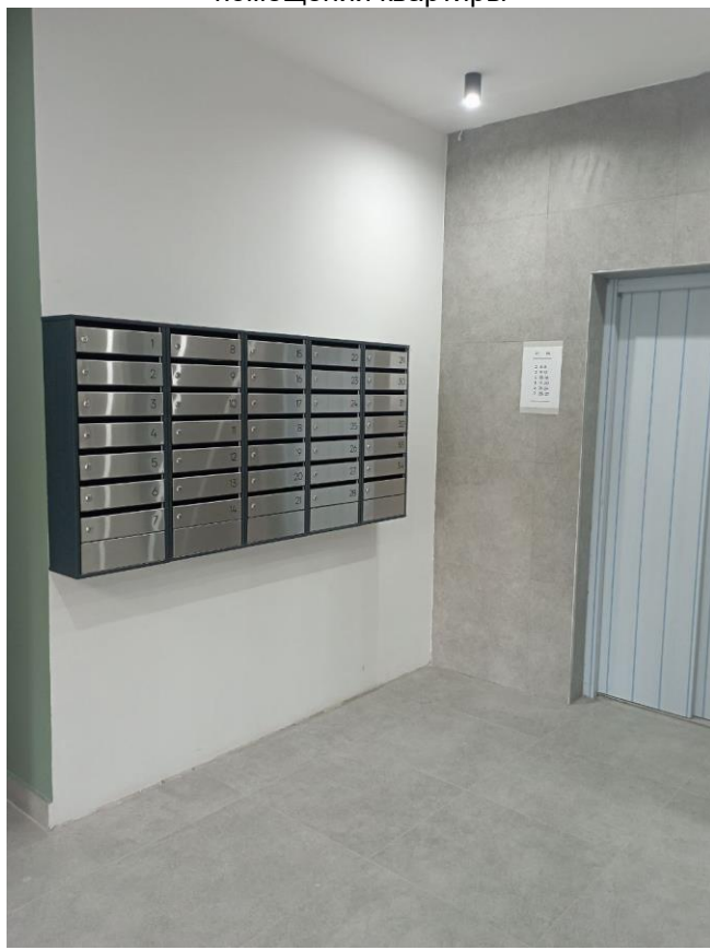
Фото №8 Техническое состояние подъезда
