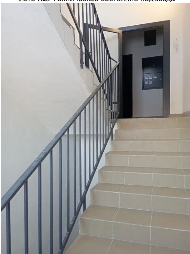
Фото №11 Техническое состояние подъезда
