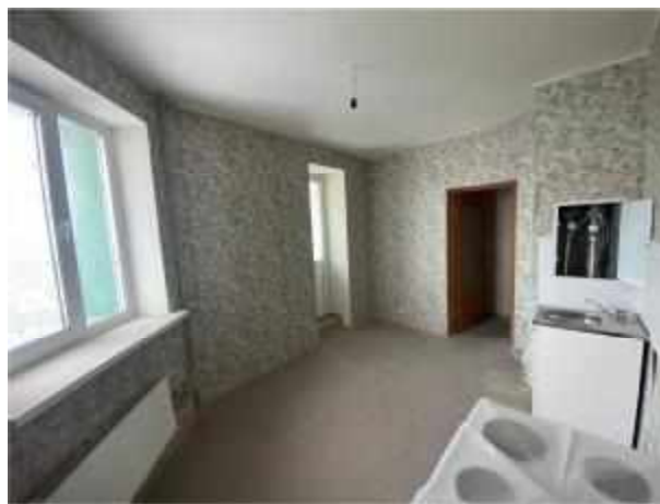
Фото 14. Состояние внутренней отделки кв.82
