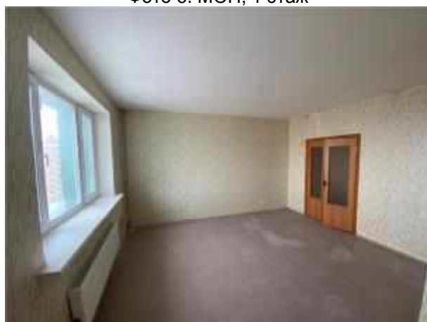
Фото 8. Состояние внутренней отделки кв.82
