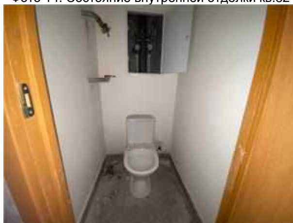
Фото 16. Состояние внутренней отделки кв.82
