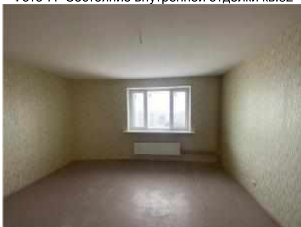
Фото 9. Состояние внутренней отделки кв.82
