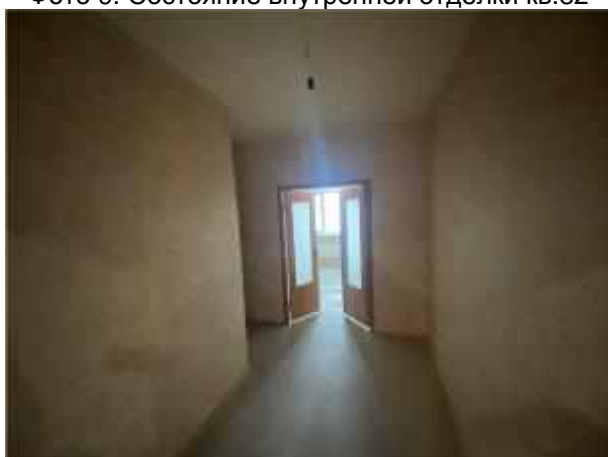
Фото 11. Состояние внутренней отделки кв.82
