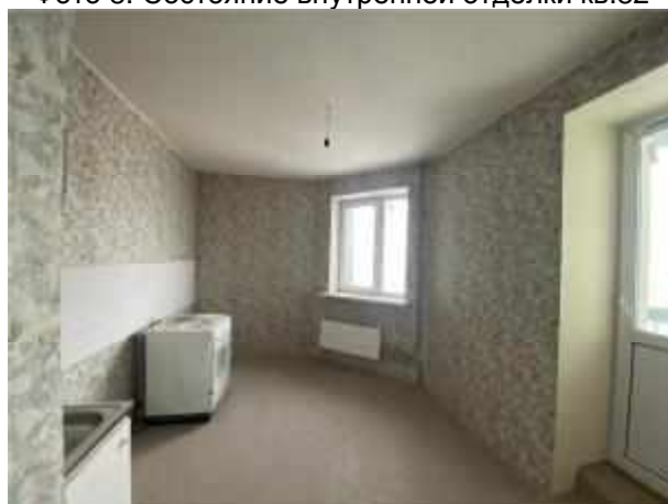
Фото 10. Состояние внутренней отделки кв.82
