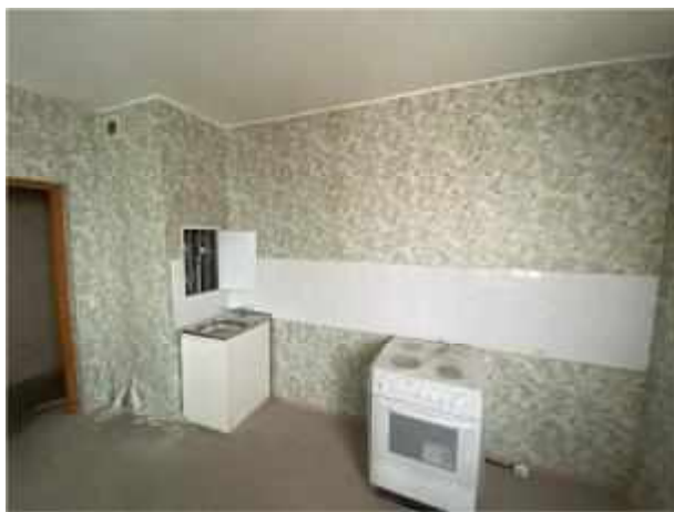
Фото 13. Состояние внутренней отделки кв.82
