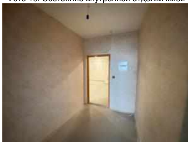
Фото 12. Состояние внутренней отделки кв.82
