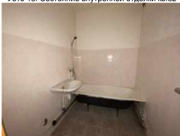
Фото 15. Состояние внутренней отделки кв.82
