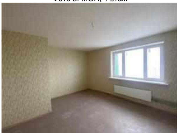
Фото 7. Состояние внутренней отделки кв.82
