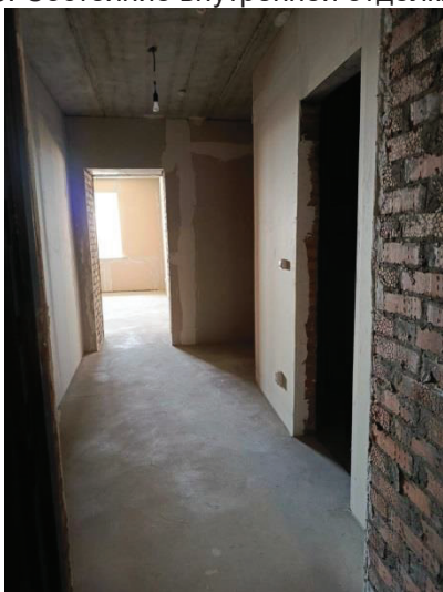
Фото 5. Состояние внутренней отделки кв.70
