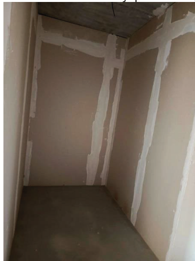
Фото 20. Состояние внутренней отделки кв.70
