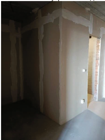
Фото 7. Состояние внутренней отделки кв.70
