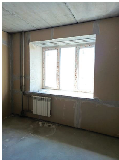
Фото 28. Состояние внутренней отделки кв.70
