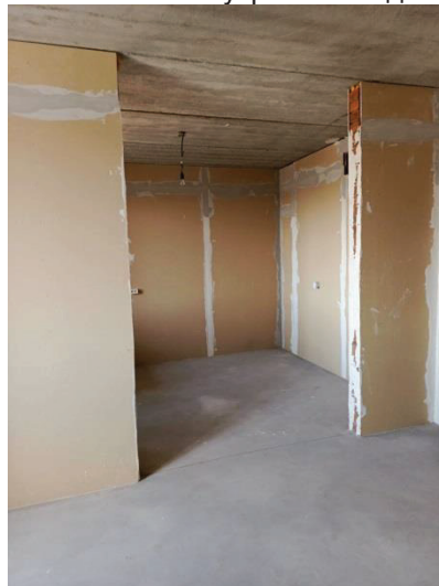
Фото 26. Состояние внутренней отделки кв.70
