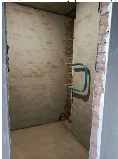
Фото 18. Состояние внутренней отделки кв.70
