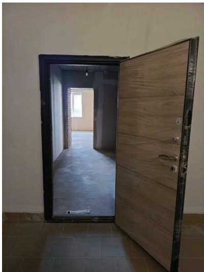
Фото 3. Состояние внутренней отделки кв.70
