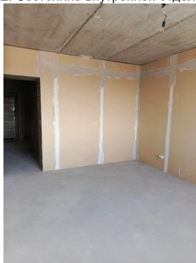
Фото 24. Состояние внутренней отделки кв.70
