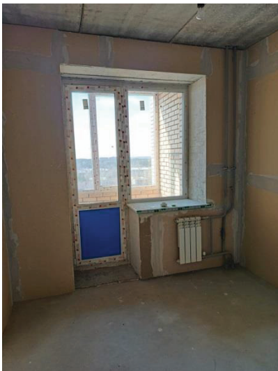
Фото 27. Состояние внутренней отделки кв.70
