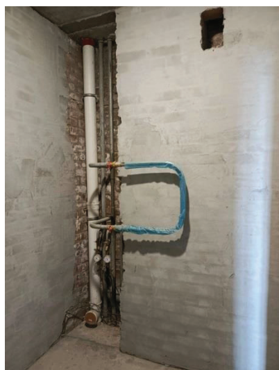
Фото 13. Состояние внутренней отделки кв.70
