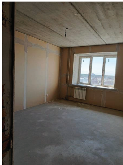
Фото 22. Состояние внутренней отделки кв.70
