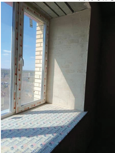
Фото 32. Состояние внутренней отделки кв.70
