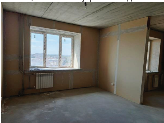
Фото 29. Состояние внутренней отделки кв.70
