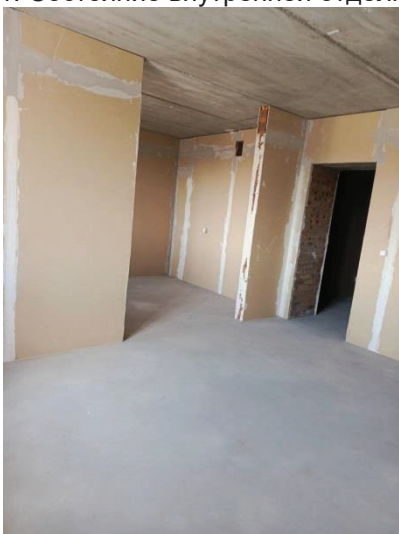
Фото 23. Состояние внутренней отделки кв.70
