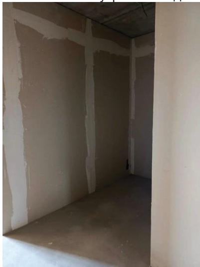
Фото 19. Состояние внутренней отделки кв.70
