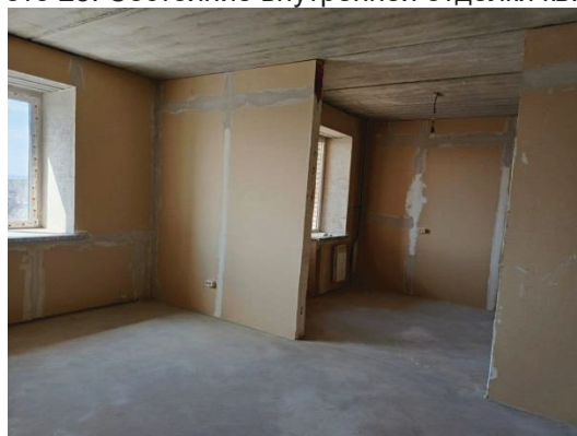
Фото 30. Состояние внутренней отделки кв.70
