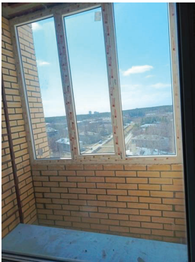
Фото 34. Состояние внутренней отделки кв.70
