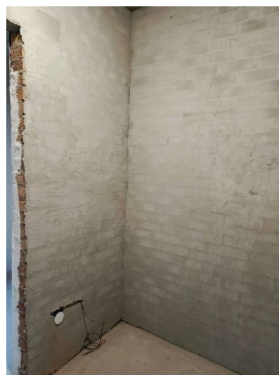
Фото 14. Состояние внутренней отделки кв.70
