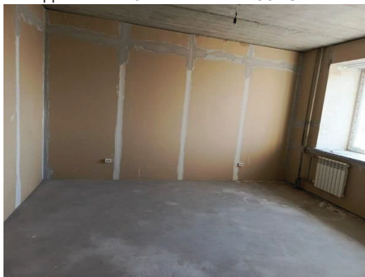
Фото 31. Состояние внутренней отделки кв.70
