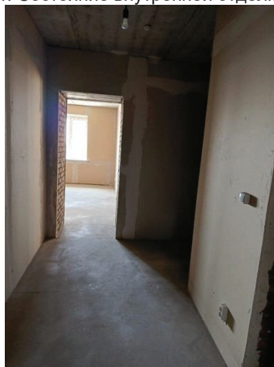
Фото 6. Состояние внутренней отделки кв.70
