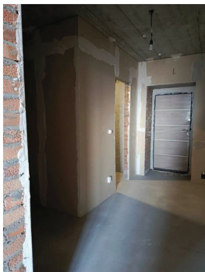
Фото 9. Состояние внутренней отделки кв.70
