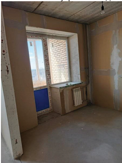
Фото 25. Состояние внутренней отделки кв.70
