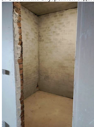
Фото 12. Состояние внутренней отделки кв.70
