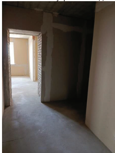
Фото 8. Состояние внутренней отделки кв.70
