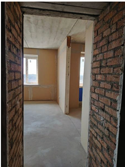
Фото 21. Состояние внутренней отделки кв.70
