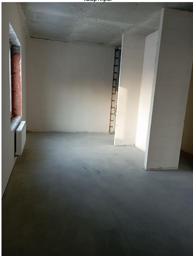
Фото №3 Техническое состояние внутренних помещений квартиры
