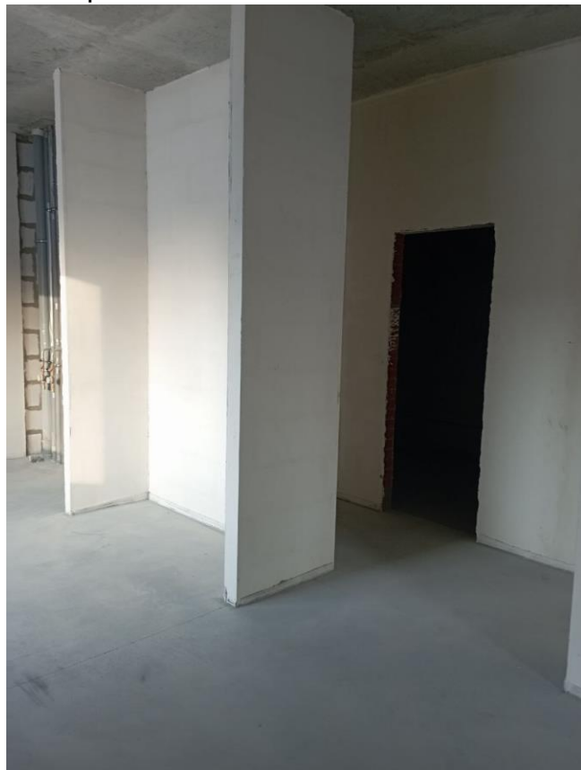
Фото №2 Техническое состояние внутренних помещений квартиры
