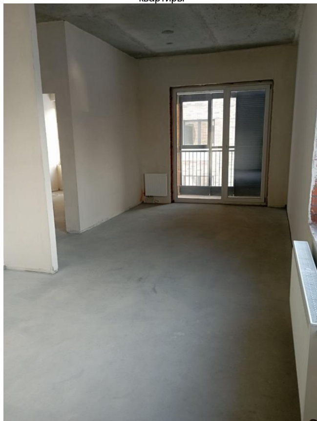
Фото №4 Техническое состояние внутренних помещений квартиры
