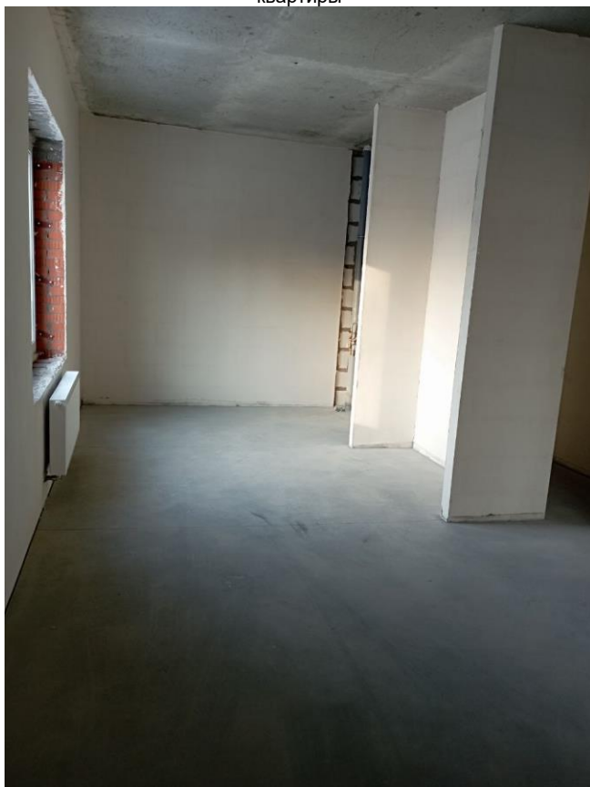
Фото №3 Техническое состояние внутренних помещений квартиры
