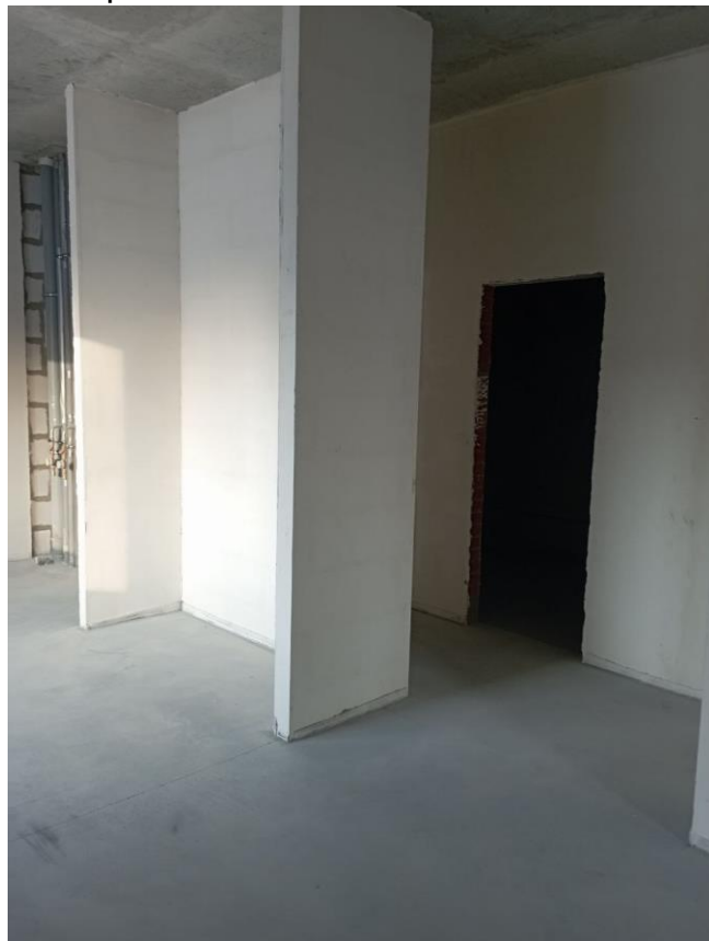
Фото №2 Техническое состояние внутренних помещений квартиры
