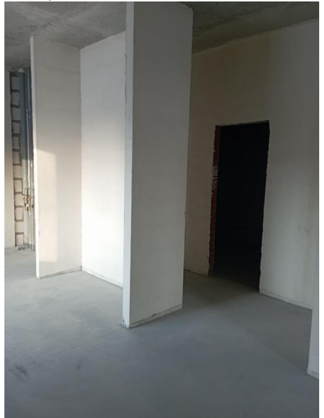
Фото №2 Техническое состояние внутренних помещений квартиры
