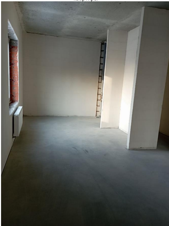
Фото №3 Техническое состояние внутренних помещений квартиры
