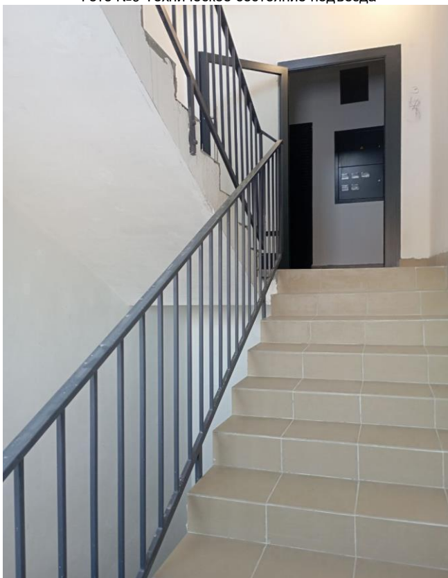
Фото №11 Техническое состояние подъезда
