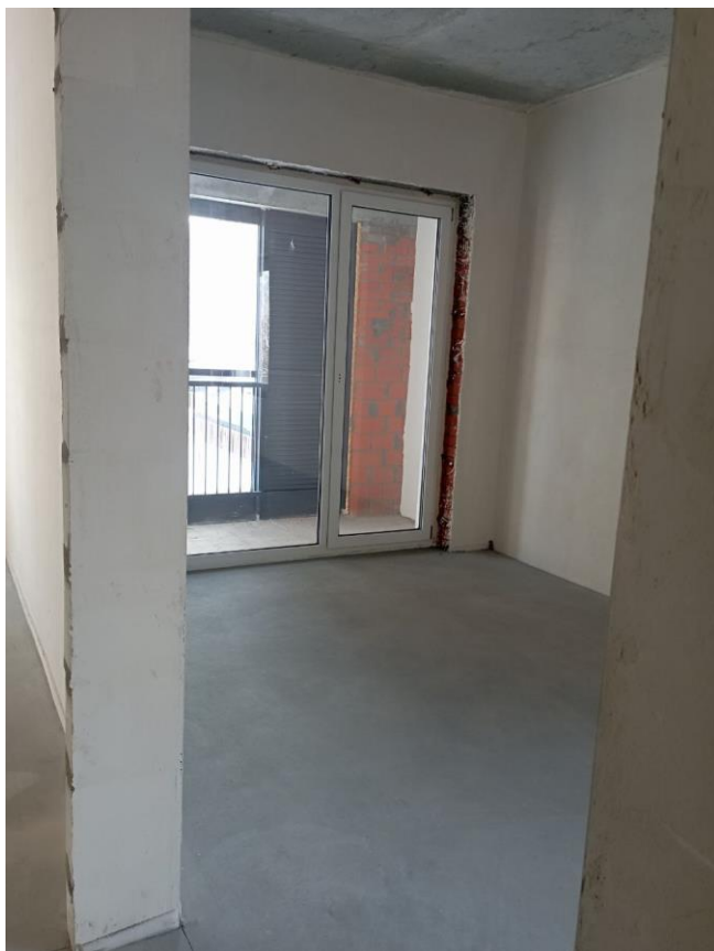
Фото №5 Техническое состояние внутренних помещений квартиры
