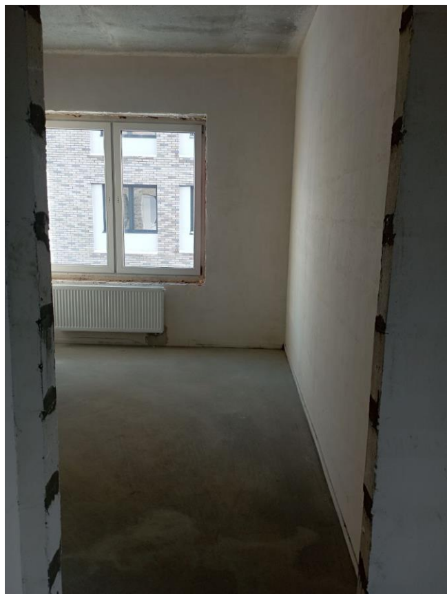
Фото №6 Техническое состояние внутренних помещений квартиры
