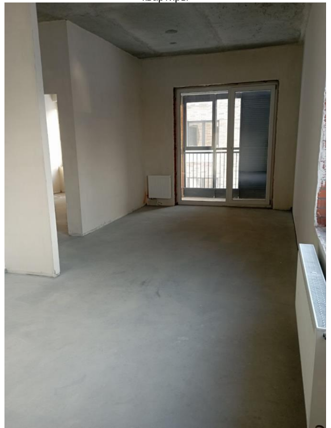
Фото №4 Техническое состояние внутренних помещений квартиры
