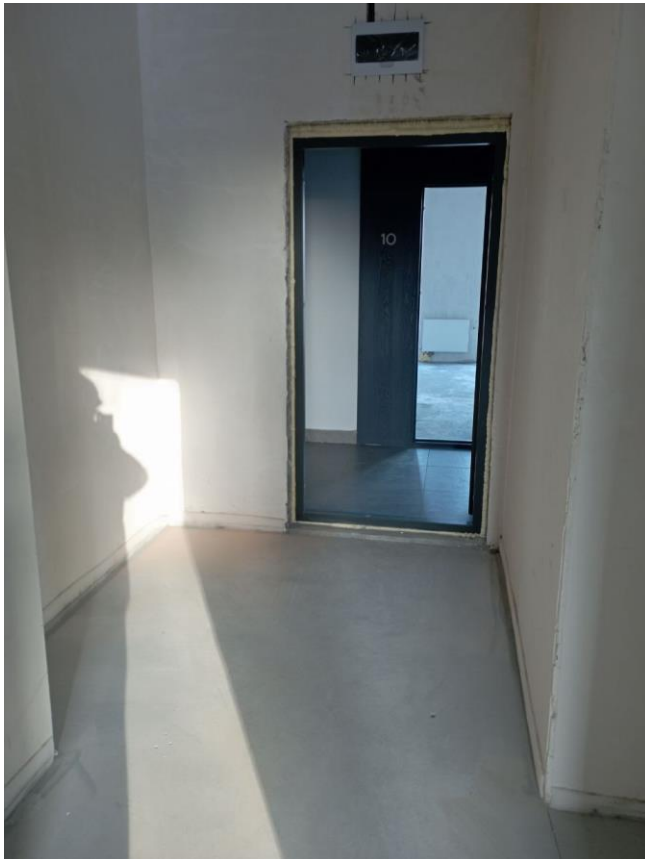
Фото №1 Техническое состояние внутренних помещений квартиры
