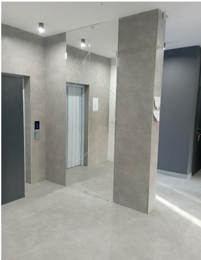
Фото №9 Техническое состояние подъезда
