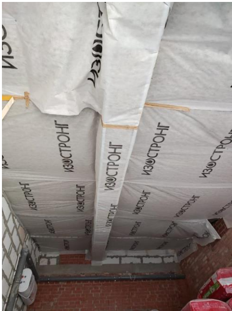
Фото 13. Состояние внутренней отделки кв.69
