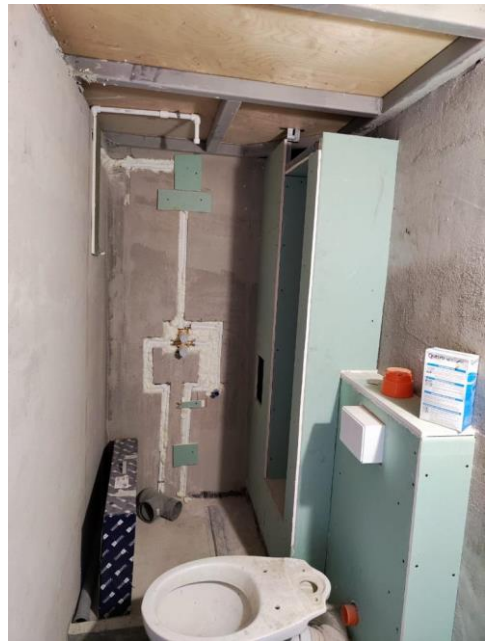
Фото 14. Состояние внутренней отделки кв.69
