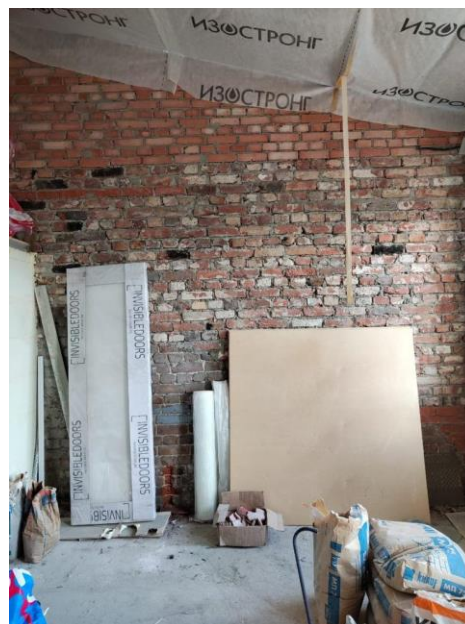
Фото 8. Состояние внутренней отделки кв.69
