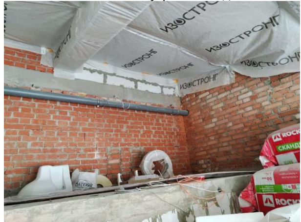
Фото 16. Состояние внутренней отделки кв.69
