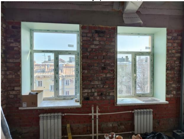
Фото 15. Состояние внутренней отделки кв.69
