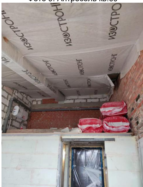
Фото 11. Состояние внутренней отделки кв.69
