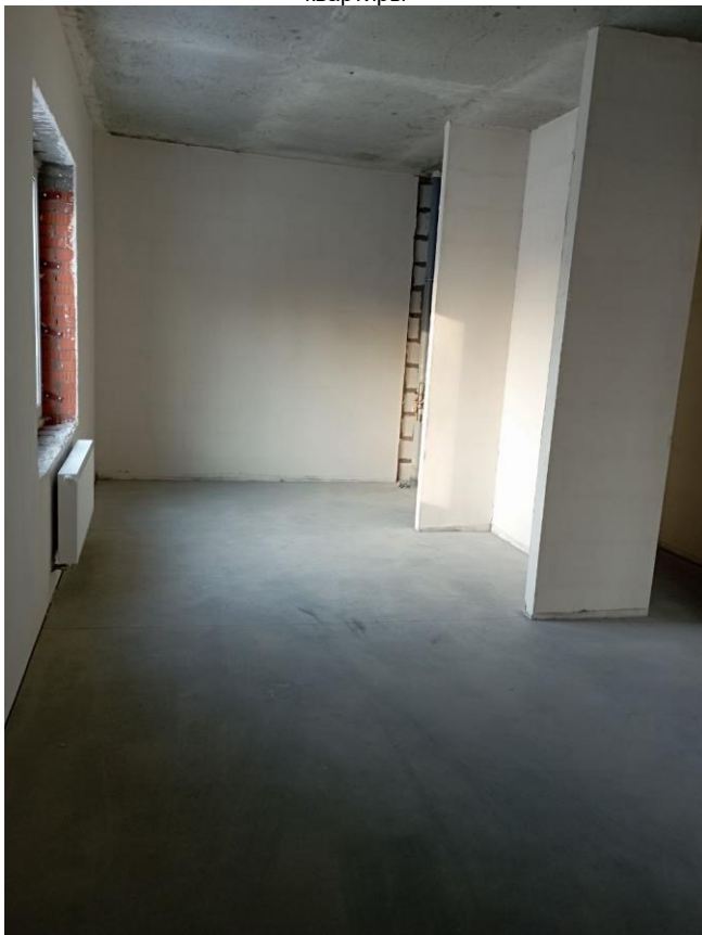
Фото №3 Техническое состояние внутренних помещений квартиры
