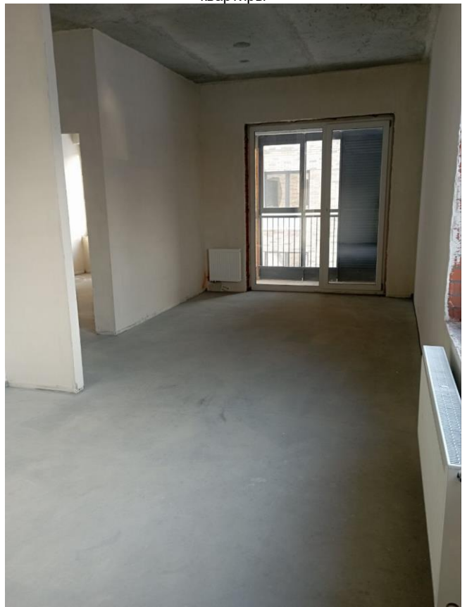
Фото №4 Техническое состояние внутренних помещений квартиры
