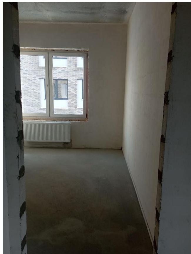
Фото №6 Техническое состояние внутренних помещений квартиры
