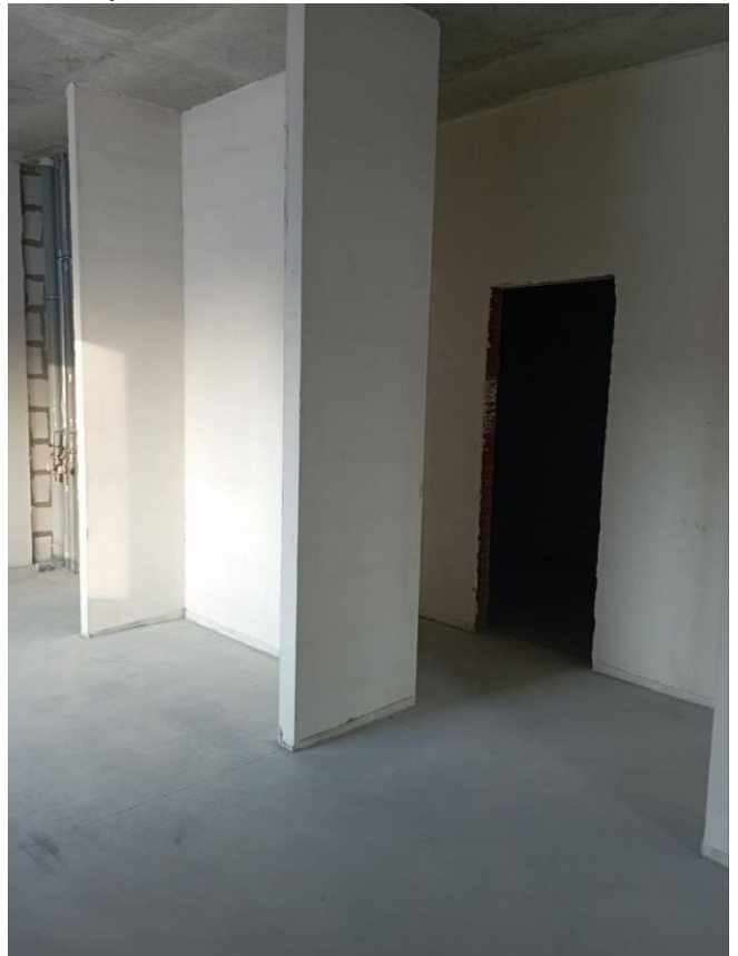
Фото №2 Техническое состояние внутренних помещений квартиры
